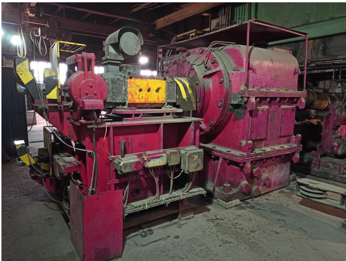
21. ábra Húzóhengerek hajtása (Hübner jeladó a baloldalon látható)
